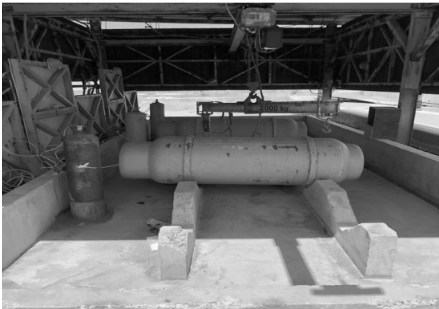
صورة (9): وحدة الكلور
