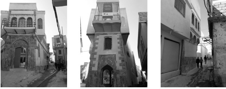
موقع الجامع والدور السكنية التراثية المحيطة به أثناء عملية اعادة الاعمار مؤخراً (تصوير: الباحثان)
